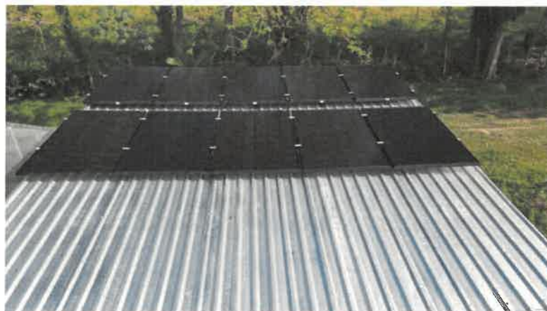
Placas Solares instaladas
